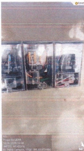
QUADRO DE MEDIÇÃO TRIFÁSICO
