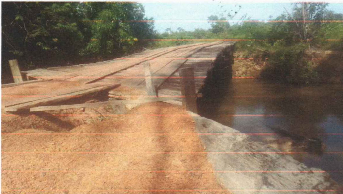
PONTE VÃO 25,00M – ÁREA URBANA (N 0° 55' 43,440"; W 60° 31' 19,423") – ATERRO DA CORTINA COMPROMETIDA A PONTE EXISTENTE É PEQUENA EM RELAÇÃO AO LARGURA DO IGARAPÉ
