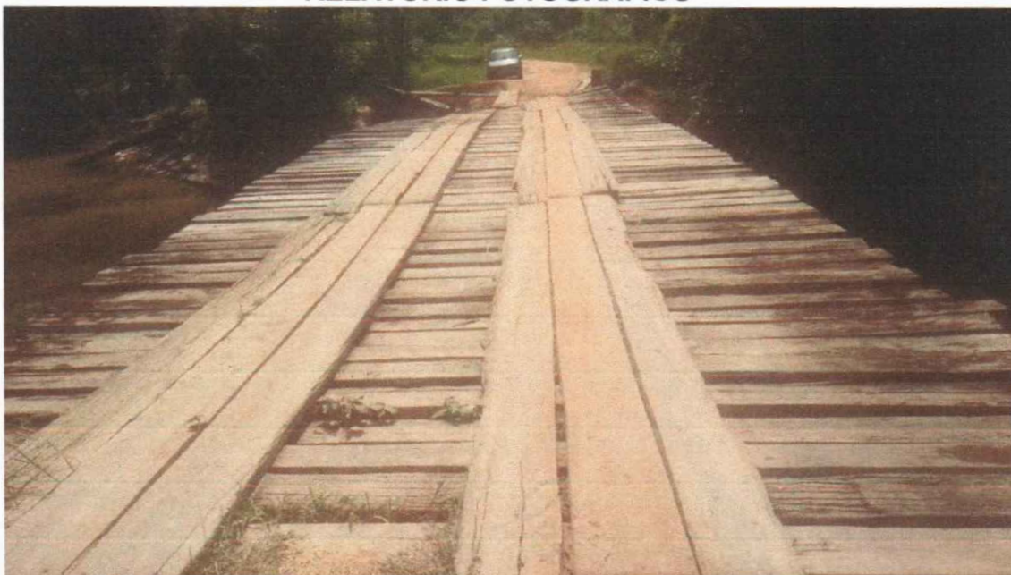
PONTE VÃO 25,00M – ÁREA URBANA (N 0° 55' 43,440"; W 60° 31' 19,423") – PONTE COMPLETAMENTE DANIFICADA
