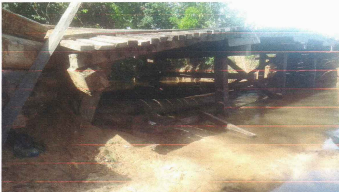
PONTE VÃO 25,00M – ÁREA URBANA (N 0° 55' 43,440"; W 60° 31' 19,423") – É NECESSÁRIO A DEMOLIÇÃO DE TODAS AS CORNTINAS TENDO EM VISTA A AVANÇO DO IGARAPÉ SOBRE O BARRANCO
